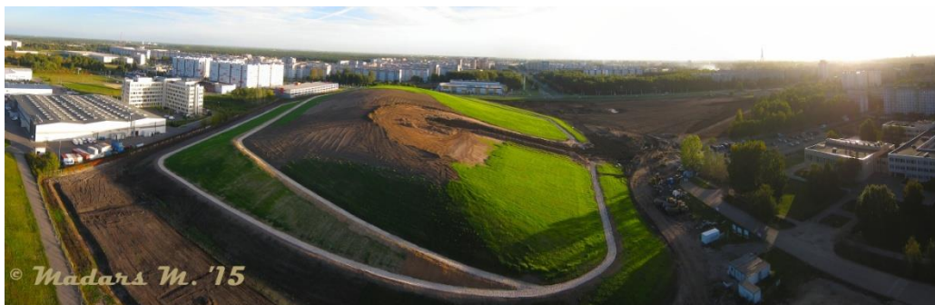
Рис. 5. Рекультивация. Свалка в Саларьево.
