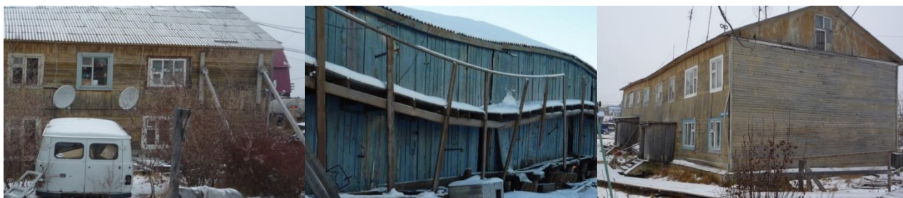
Фото 1, 2, 3. Деформация строений в п. Тазовский вызванная таянием многолетней мерзлоты.
