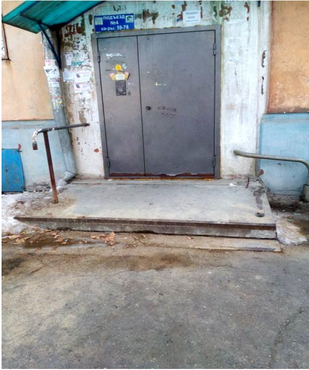
Дороги около домов покрытые льдом
